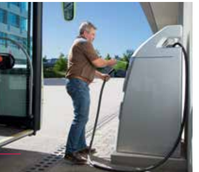
Depot Charging im Betriebshof
